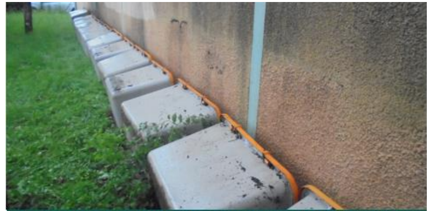
Exemple de bacs de stockage rangés de façon à limiter la rétention d'eau de pluie
